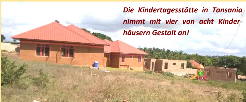
Bald kommen die Dächer drauf und parallel dazu werden derzeit die ersten drei Personalhäuser gebaut
